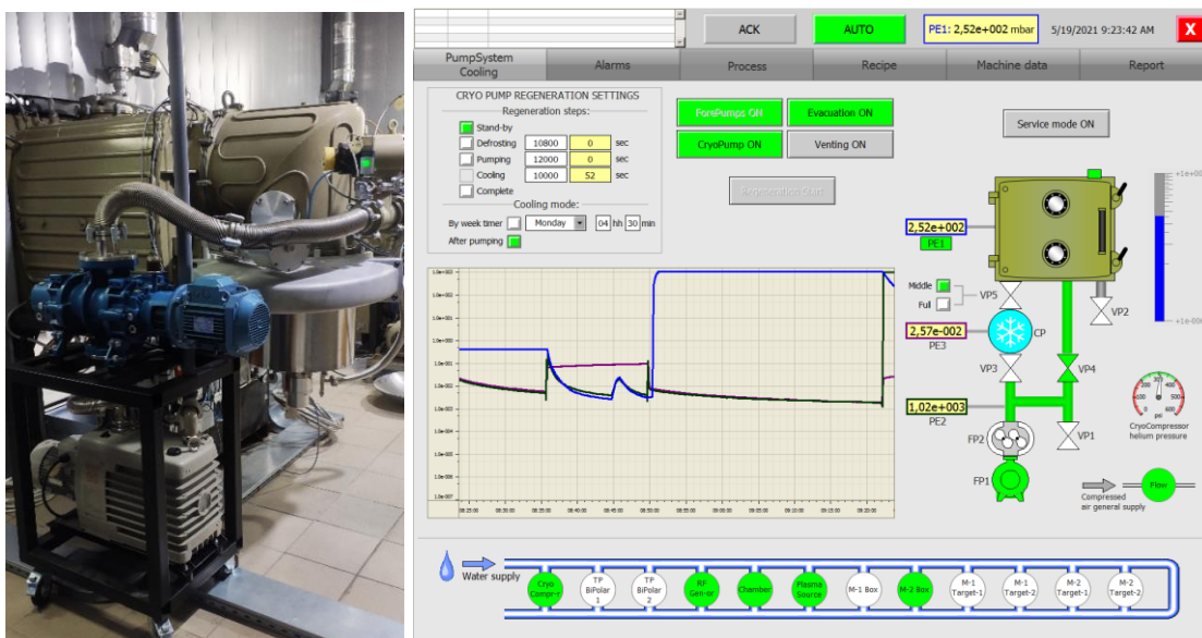
Рисунок 4. Вакуумные насосы и скриншот экрана НМИ-панели, вкладка управления откачкой.
